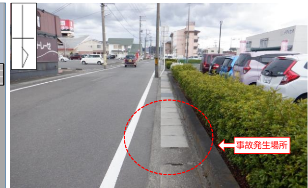
▼事故現場(改修後)
