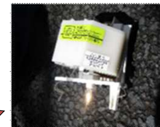
④破損状況(脱落した蓄電池およびランプ)
