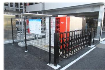
市民センター 純水素燃料電池
