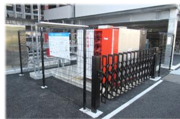
市民センター 純水素燃料電池
