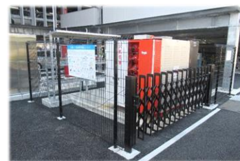
市民センター 純水素燃料電池
