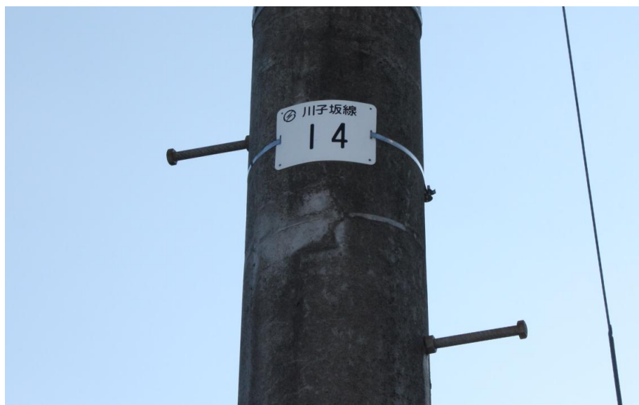
【写真一9】 接続電柱
