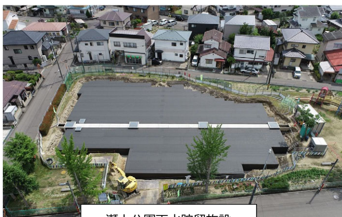
瀬上公園雨水貯留施設
