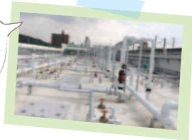
敷地内にある排水処理施設。工場で作られた排水をここで浄化しています。
