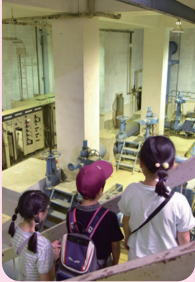
地下のポンプ室
