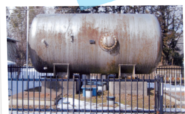
57年間、水を送り続けたタンク。東日本大震災のときも水は枯れることなく、近隣住民の皆さん以外にも開放しました。
