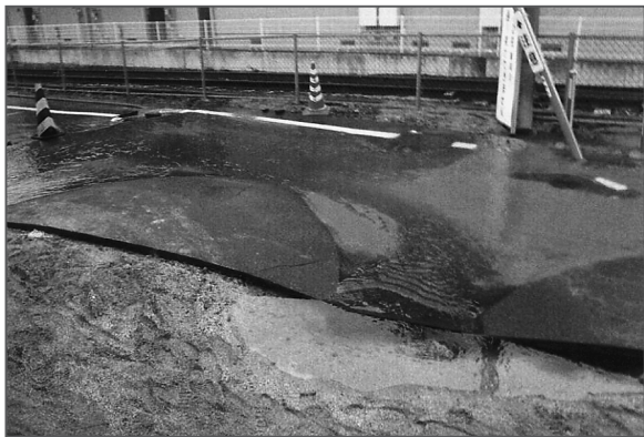
▲森合小松原地内山神系送水管 (DIP \phi 500mm) からの漏水状況
