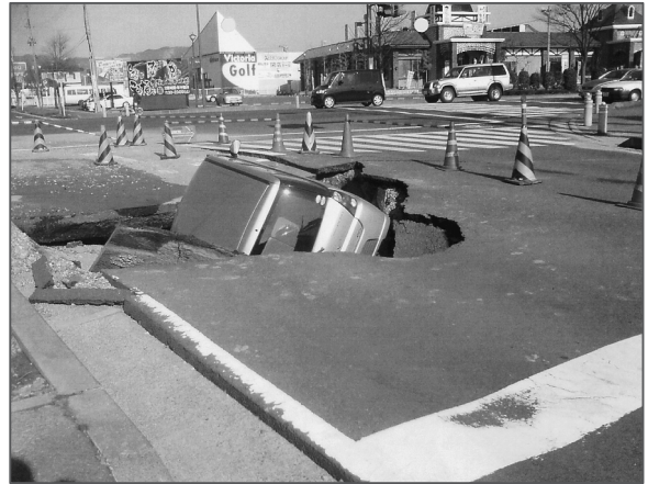
▲野田町地内道路陥没箇所
