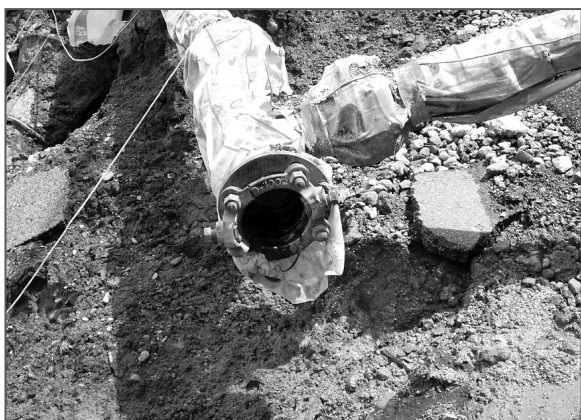
▲あさひ台団地内配水管 (DIP \phi 100mm) 破損状況
