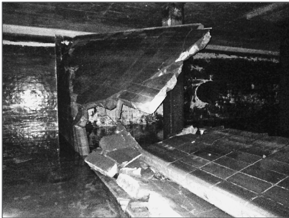
▲弁天山配水池の導流壁倒壊状況
