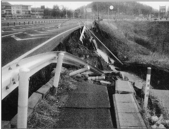
▲国道4号バイパス崩落箇所
