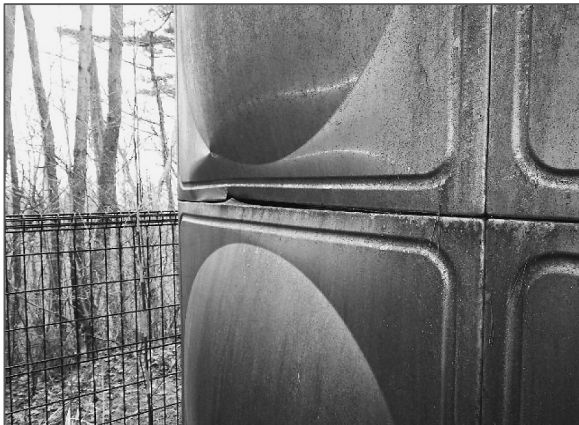
▲絵馬平配水槽の損傷状況
