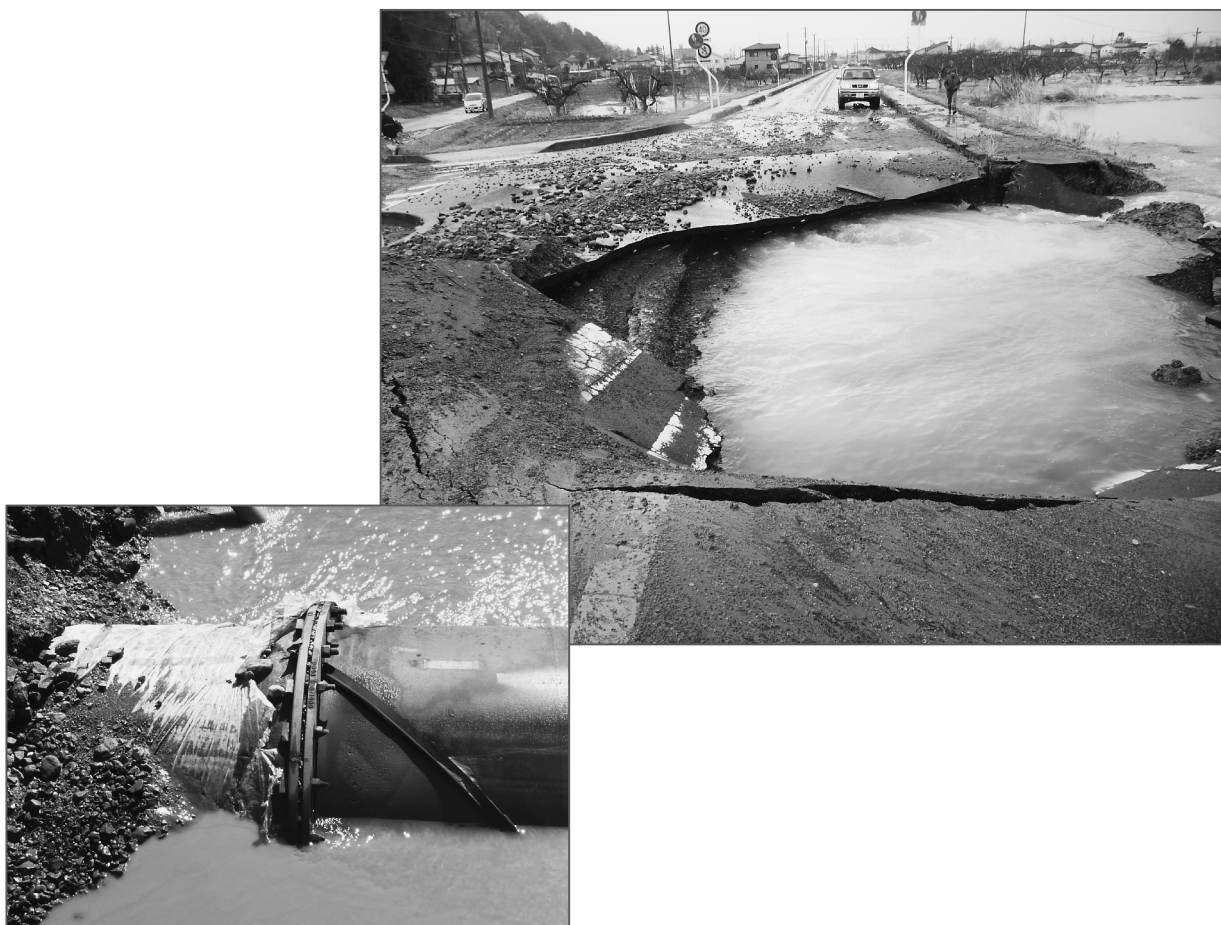
▲飯坂町中野地内送水管（DIPφ1500mm）からの漏水状況
