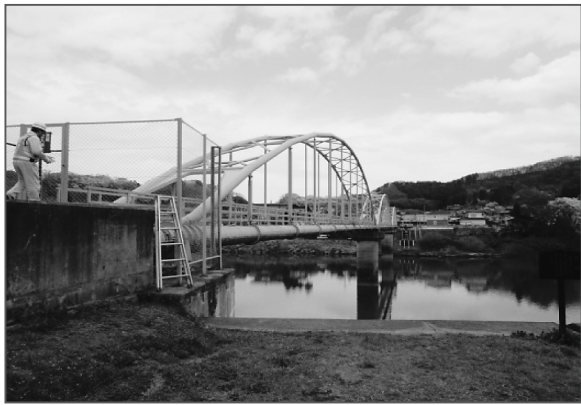
▲阿武隈川水管橋と伸縮管 (SP600A) 破損状況
