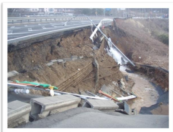
国道4号崩落状況
