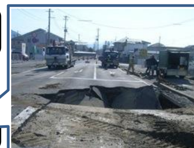
送水管φ600破損（陥没）
