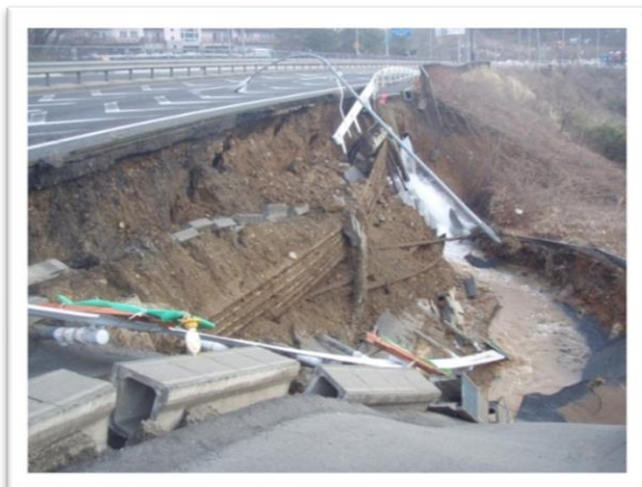
国道4号崩落状況
