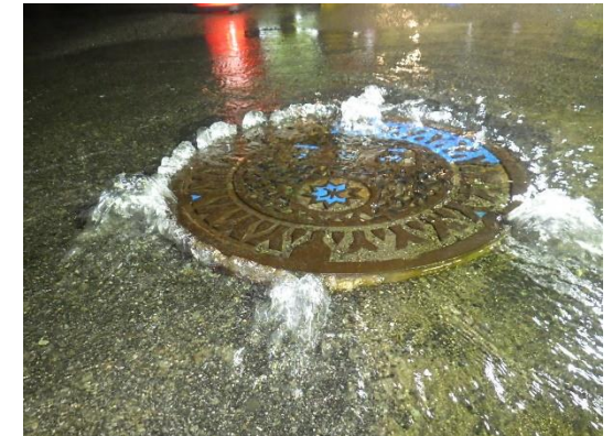
【空気弁漏水状況】
