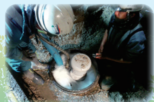
▲損傷した付帯設備の修繕状況
