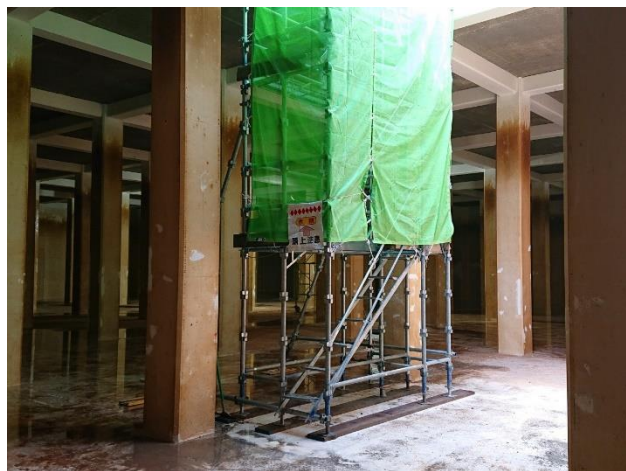
配水池内部 (昇降設備)
