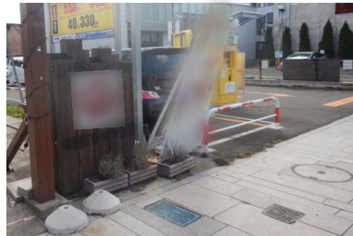
(例②) 転倒しかけているもしくは ぐらつきがみられる屋外広告物
