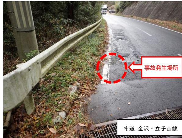
【事故発生場所】
