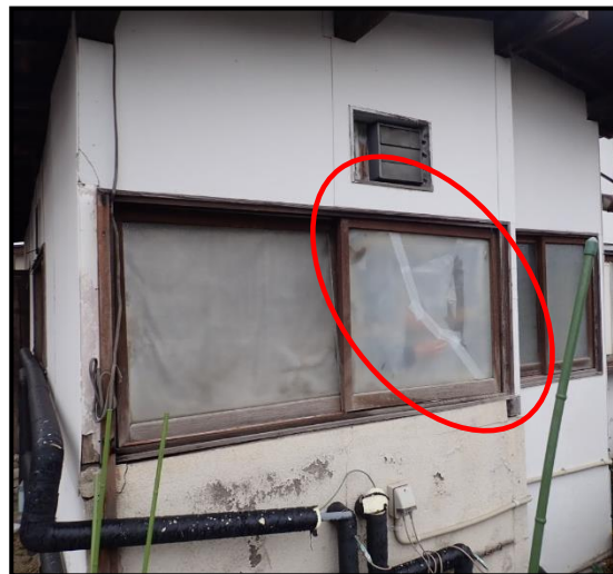
窓ガラス破損状況(テープで応急処置後)
