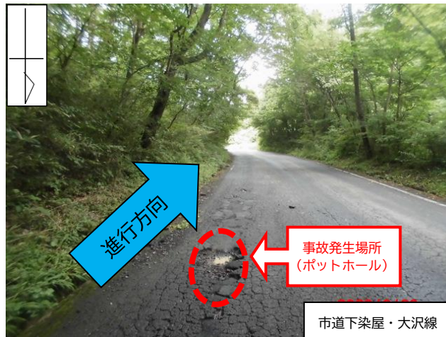
事故現場(全景)
