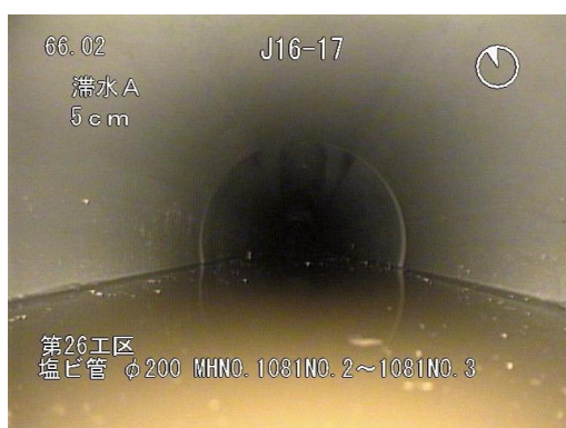
管渠内滞水が確認 管径φ200 滞水深5cm
