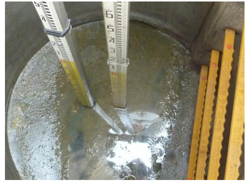
隆起したマンホール。滞水状況[小田字馬場地内]
