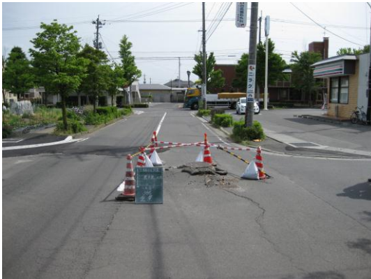
マンホールの隆起[東中央二丁目地内]
