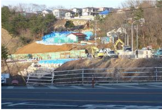
法面崩落（伏拝字沼ノ上地内）
