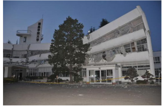
福島学院大学校舎被害 写真：日経アーキテクチャ
