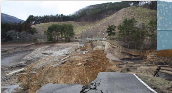
決壊した藤沼湖（福島県東日本 大震災記録写真集より）
