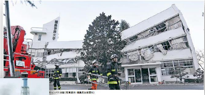
倒壊した福島学院大学宮代 キャンパス本館(福島民友より)
