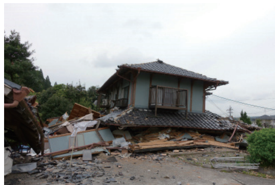
写真9 倒壊した木造住宅
