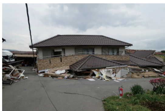
写真 16 倒壊した木造住宅
