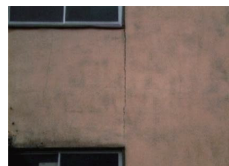
外壁の ひび割れ
