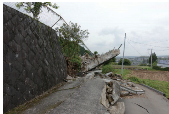
写真11 崩壊した擁壁
