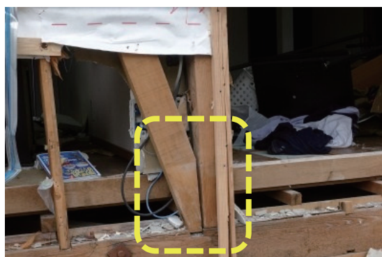
写真 15 写真 14 のアパートの柱脚部 (柱脚、筋かい端部は釘打ちのみ)
