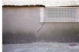
基礎のひび割れ
