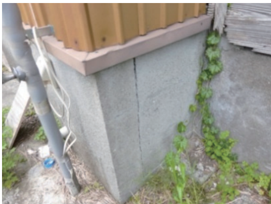
写真Ⅱ.2.2.6 基礎の割れ
