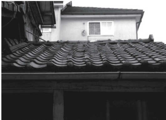
写真Ⅱ.2.2.4 屋根の波打ち (中央上部の屋根の棟線にたわみが見られる)
