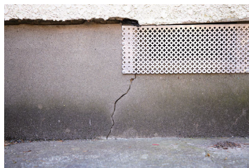
換気口付近の ひび割れ
