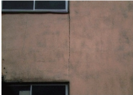
写真Ⅱ.2.2.5 モルタル外壁に生じた大きなひび割れ
