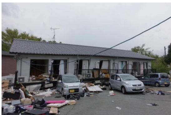
写真 12 倒壊した木造アパート
