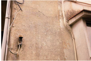
外壁のひび割れ・こけ
