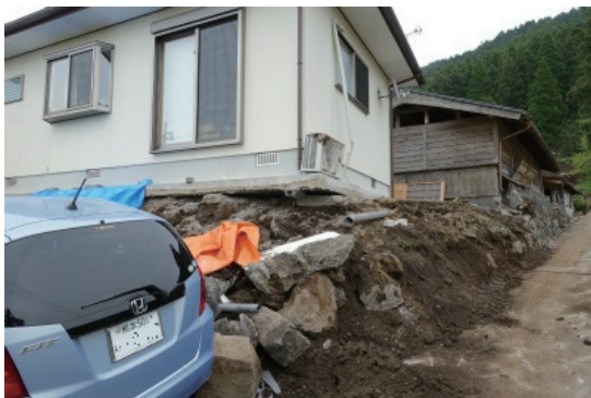
写真10 崩壊した擁壁
