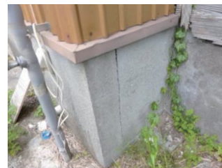
基礎の ひび割れ
