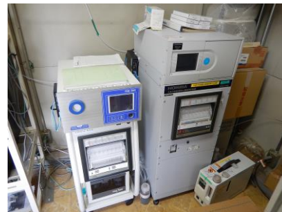
大気汚染測定局内の測定機器 （森合小学校）
