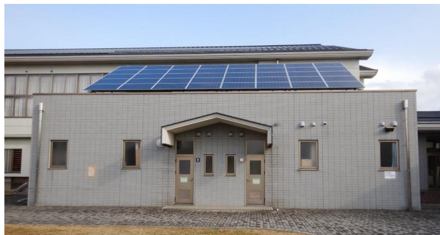
清水学習センターの太陽光発電設備
