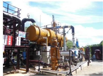
土湯温泉バイナリー発電所
