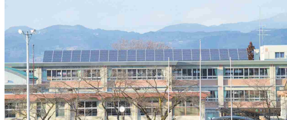
太陽光発電パネル (福島第三中学校)
