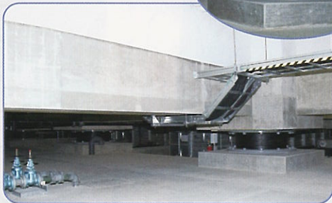
建物と地面の間にある免震装置
