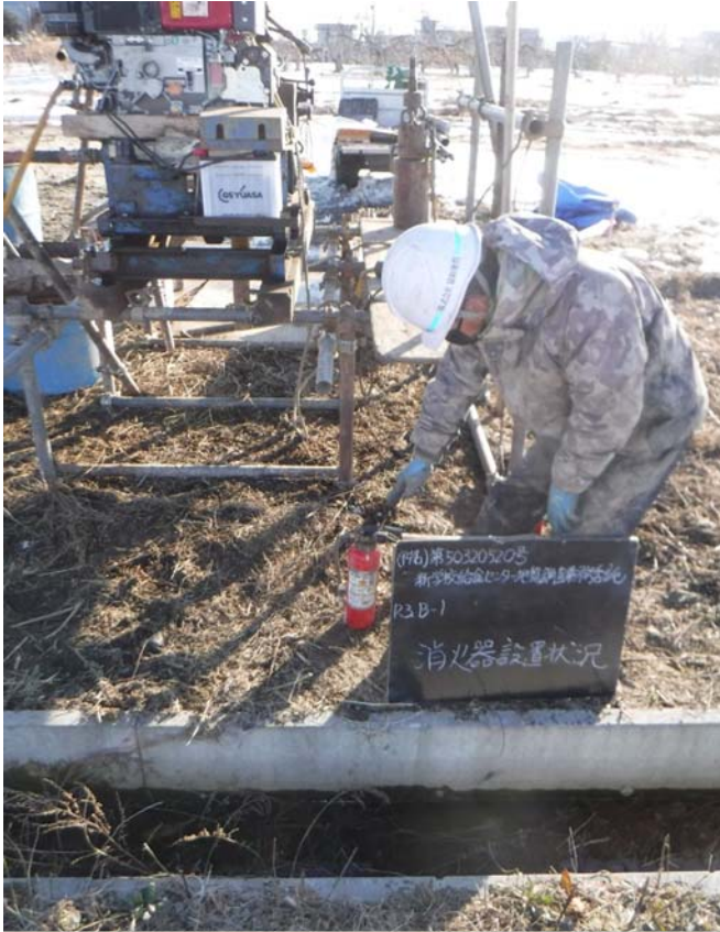
消 火 器 設 置 状 況
