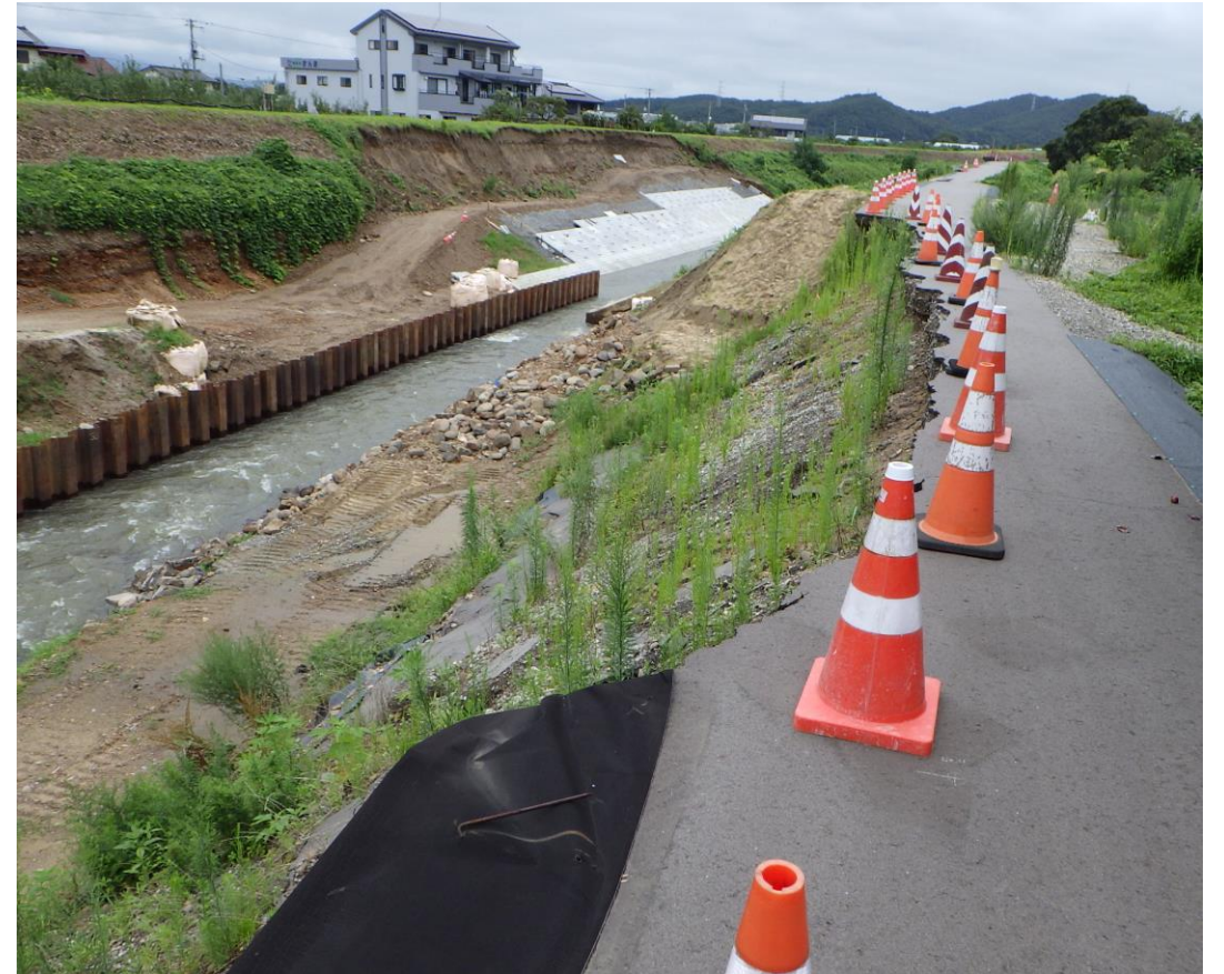
八反田川の護岸一部崩落
