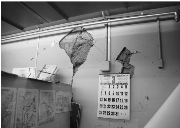
福島市水道局の被災状況
