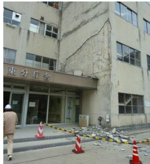
県庁東分庁舎の被災状況
