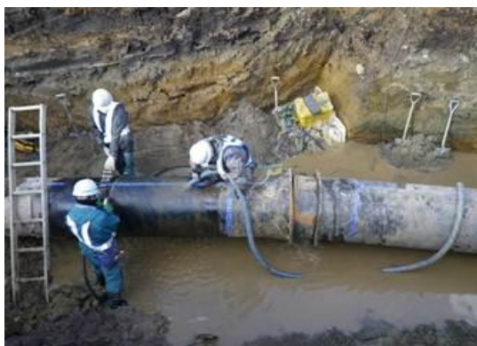
送水管の破損
