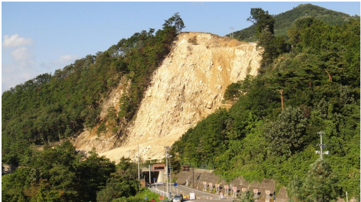
国道399号角間下ロックシェッド法面崩壊
