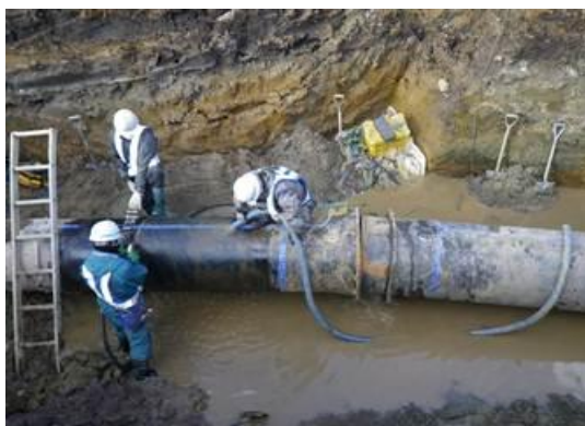
送水管の破損
