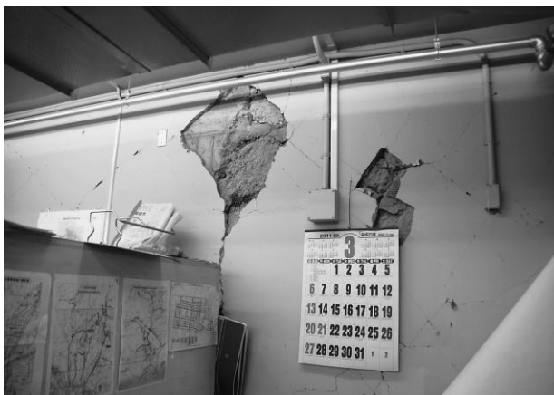
福島市水道局の被災状況
