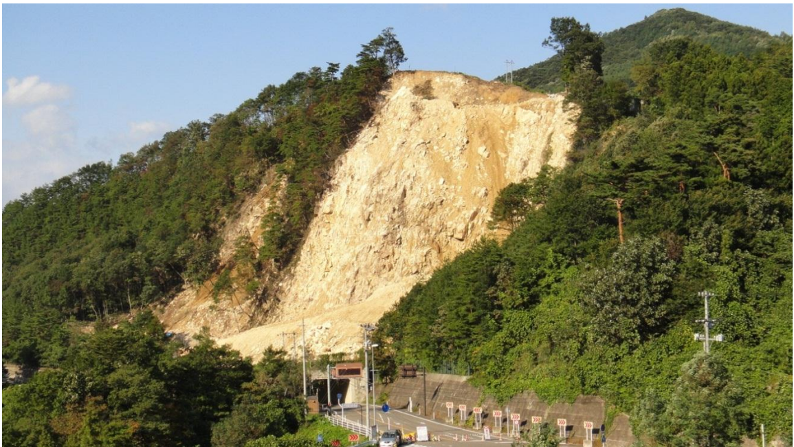
国道399号角間下ロックシェッド法面崩壊
