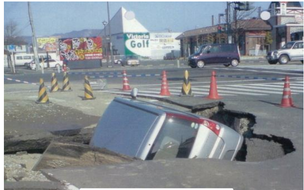
野田町地内道路陥没箇所
