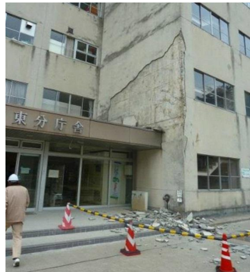
県庁東分庁舎の被災状況
