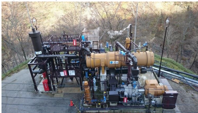
これからの街づくりの柱としてスタートしたバイナリー発電設備。温泉供給と同時に毎時400kwの発電がなされている。
