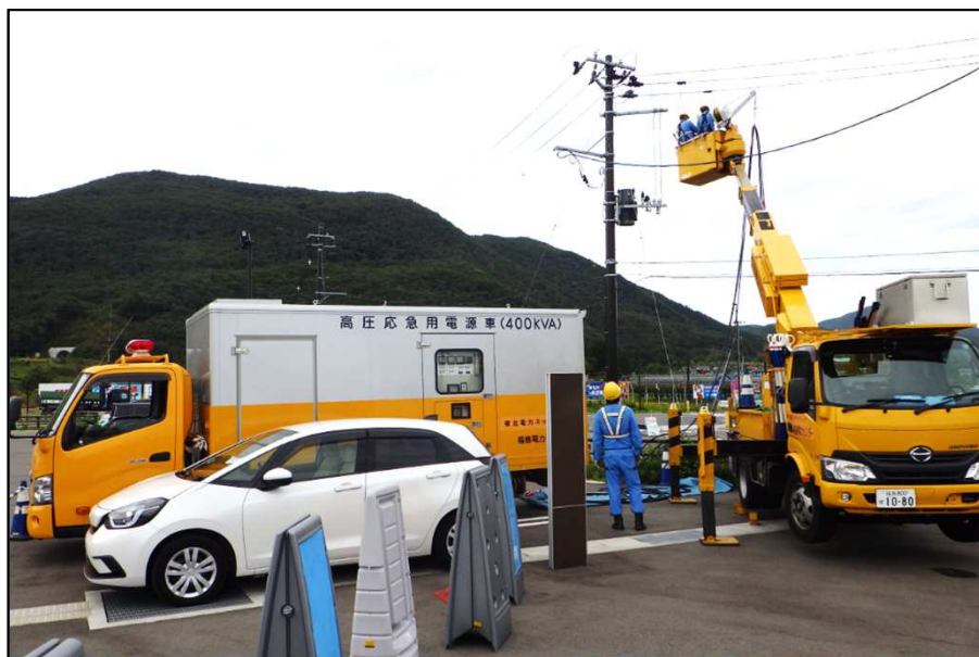
電源車(東北電力ネットワーク)から施設等へ電力供給
