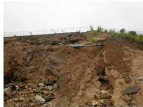
法面崩落による土砂流出の状況
