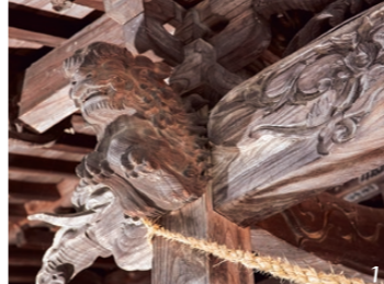
1/大仏様木鼻。獅子鼻と猿鼻を対に礼堂軒下の左右にある。木鼻は木の先端という意の「木端」が転じたもの 2/四季の草花をモチーフにした50枚の格天井がある礼堂。大福寺観音堂も奈良の興福寺南円堂も三十三観音第9番札所というご縁で明治14年、地域の人々が奈良を詣でた様子を描いた額も奉納されている
