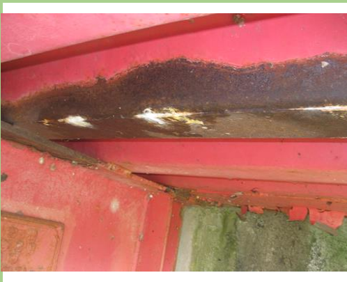
鋼桁塗装の剥離・錆
