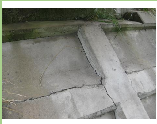
護岸ブロックのひびわれ
