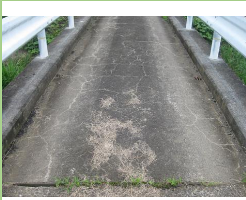
床版のひび割れ
