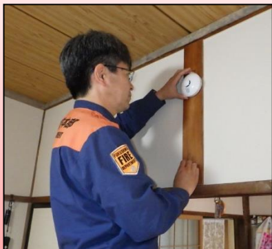
令和元年度に実施した 取り付け状況の様子
