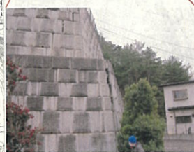
○部 擁壁破壊状況
