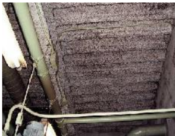
石綿含有吹付けロックウール
