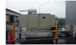
非常用発電機【高山市】
