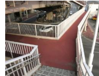
③ 階段を利用しないと 駅東口に行けない (あずま陸橋)
