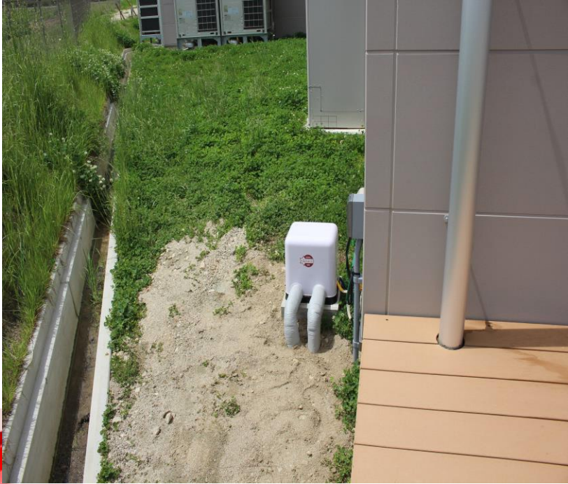
くみ上げポンプ
